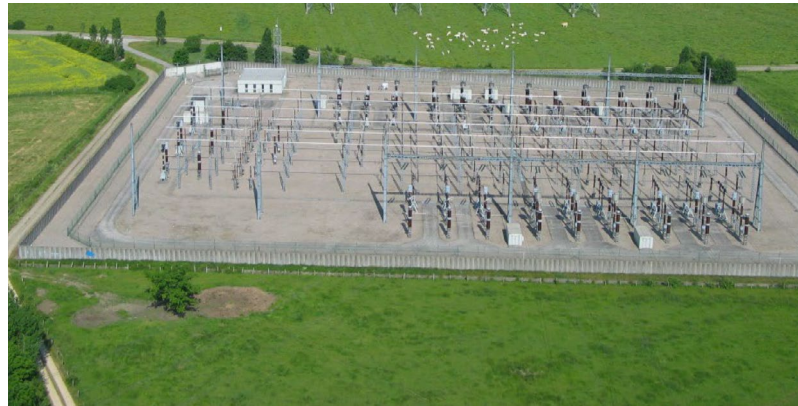
Figure 24 - Exemple de poste électrique sans transformateur (RTE)
